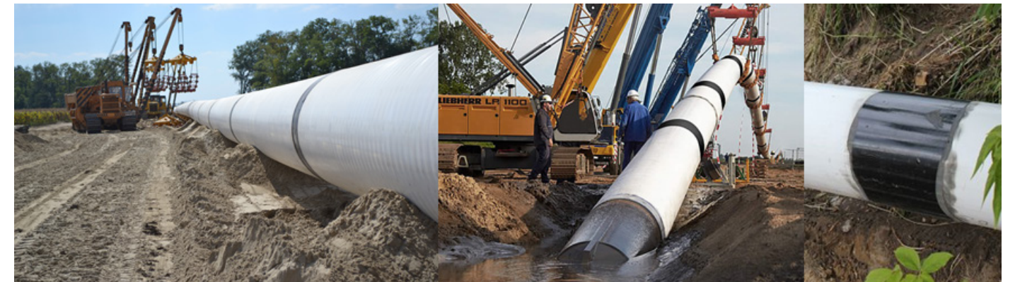
Abbildung 9: Rohrleitung mit durch Polyurethan geschützten Schweißnahtnachumhüllungen
