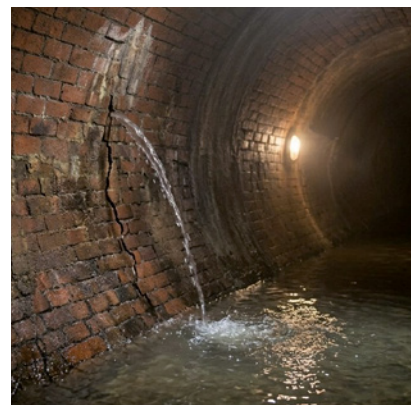
Fremdwasser ist ein zentrales Thema bei den diesjährigen KanalbetriebsTagen. | Foto: B_I MEDIEN, KI-generiert
