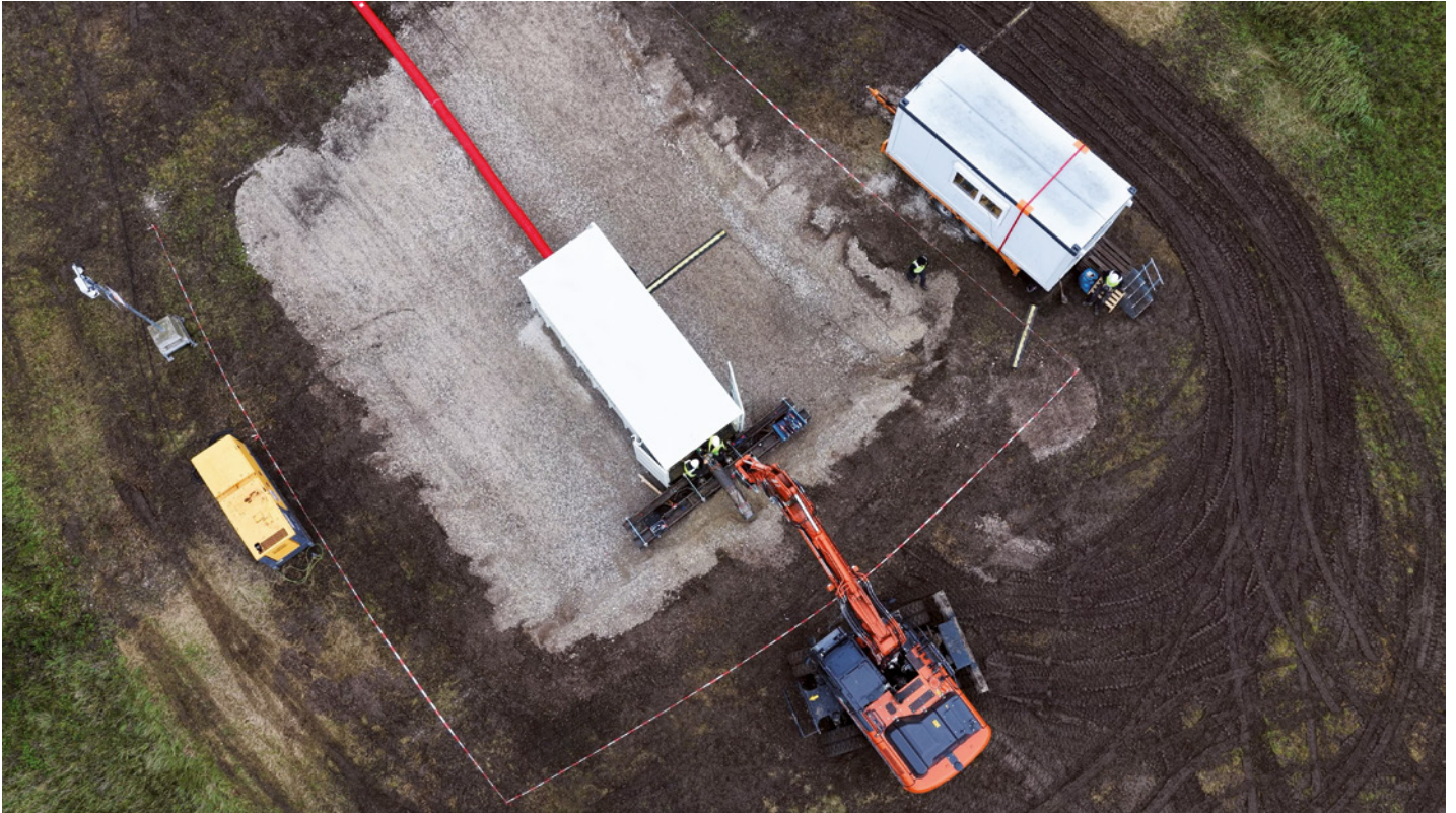
Baustelleneinrichtung im Pilotfeld. Der Rohrstrang wird direkt in den Baugrund eingebracht. | Fotos: Allunderground
