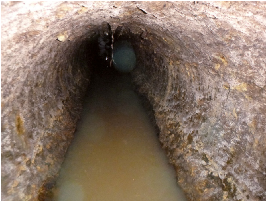
Zustand der DN 1000-Stahlleitung vor der Reinigung – Ablagerungen auf der Korrosionsschutzschicht machten eine aufwendige Vorbereitung der Haltung erforderlich. | Fotos: RelineEurope
