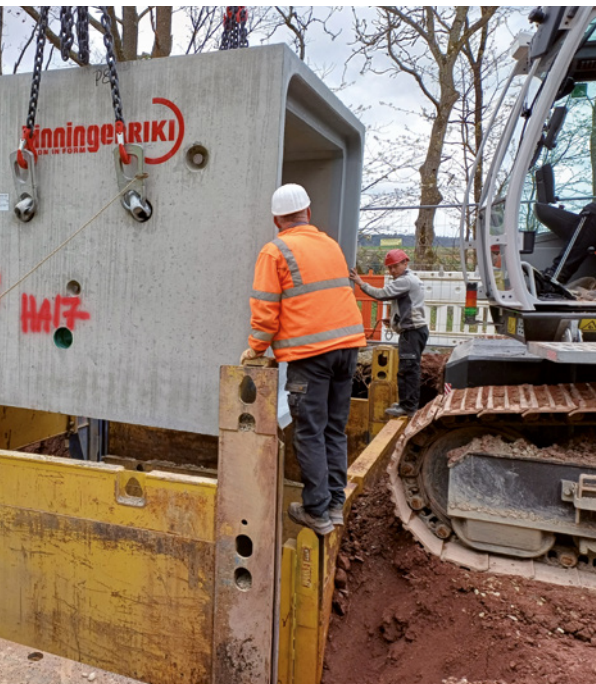
Die Mischwasserrückhaltung erfolgt kaskadenförmig über 9 Sonderbauwerke vom Betonwerk Hans Rinninger u. Sohn GmbH u. Co. KG. | Foto: Peter Gross Infrastruktur GmbH & Co. KG
