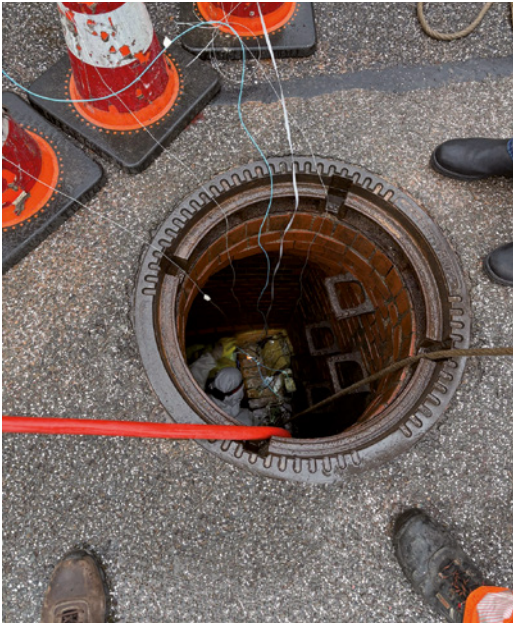
Verlauf der Messkabel durch den Schacht zum Liner | Fotos: RelineEurope
