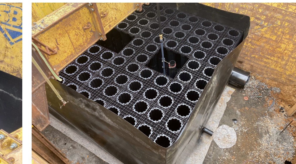
Die Rigole Stormbrixx wird mit einer Kunststoffdichtungsbahn von der Firma Aris eingeschweißt. Damit ist das Speicherbecken auf Dauer dicht.
