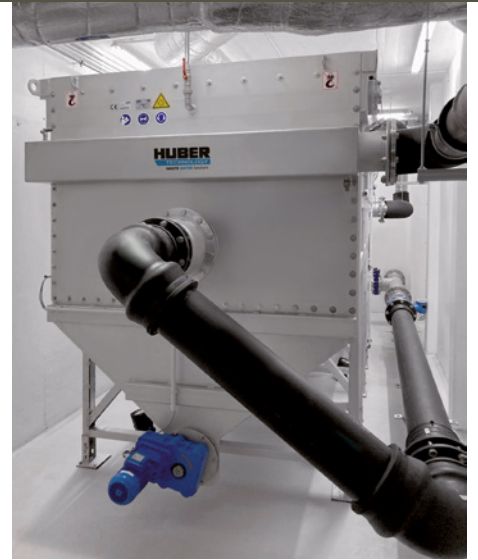
Über den Abwasserwärmetauscher RoWin wird im Winter eine Wärmepumpe und im Sommer eine Kältemaschine betrieben. | Foto: Huber SE
