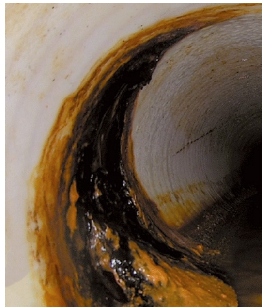
Deutlich sind die infolge von Fremdwassereintritt hervorgerufenen Inkrustationen zu sehen. | Foto: SELH
