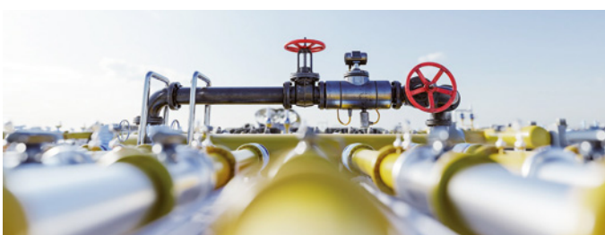
Intelligente Gefahrensuche für eine lückenlose Versorgung: Der hohe Aufwand bei der Überwachung von Gastransportleitungen kann durch den Einsatz von KI digitalisiert werden. | Foto: iStock / NiseriN
