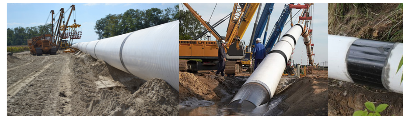
Abbildung 9: Rohrleitung mit durch Polyurethan geschützten Schweißnahtnachumhüllungen
