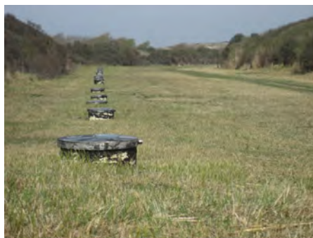
Abb. 4: Es müssen zahlreiche vertikale Brunnen angelegt werden, um bei einem dünnen Aquifer die erforderliche Kapazität zu erreichen.
